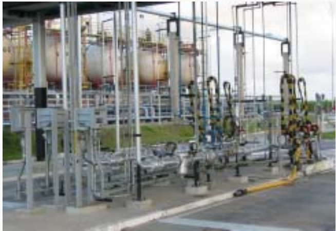
Terminal de Carregamento da UPGN
