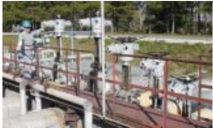
Atuadores na área de tranasferência
