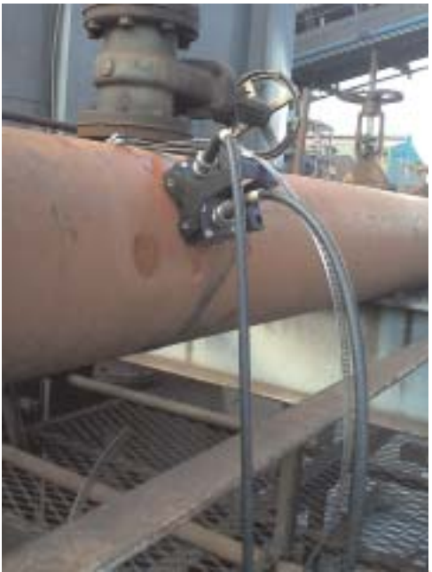
Transdutor doppler instalado do lado externo do tubo
