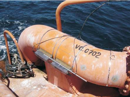
Medidor instalado em monobóia do Tefran
