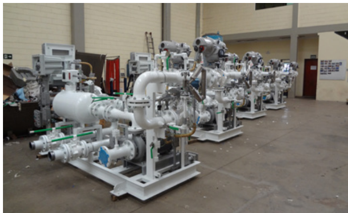
Skids de descarregamento em galpão
