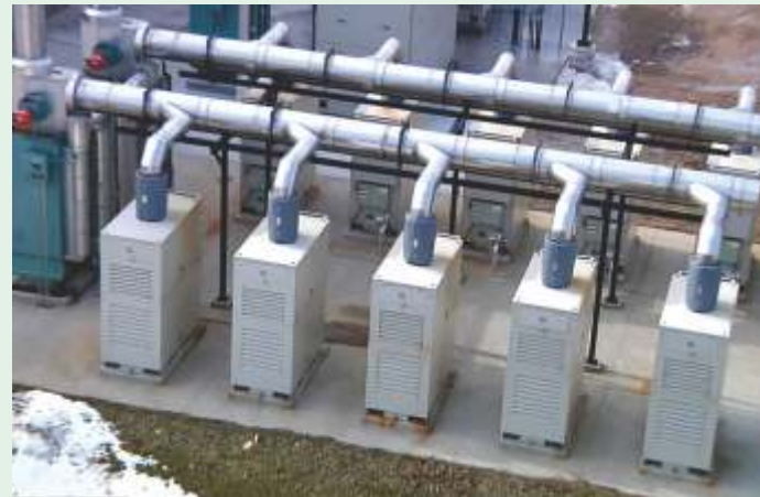
Microturbinas Capstone em estação de tratamento de esgoto
